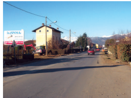
Asfalto dissestato in via Favria
